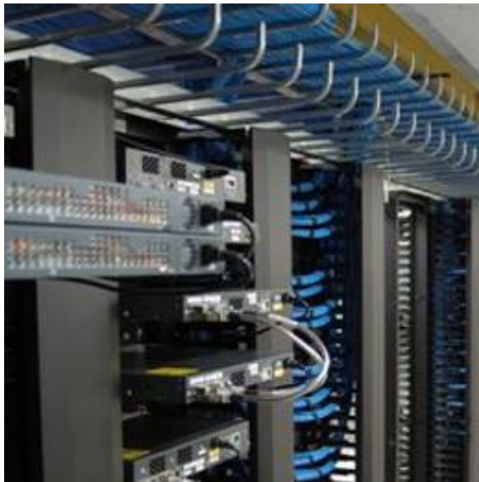
Εικόνα 2. Δικτύωση σε racks
