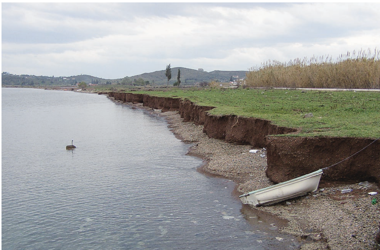
Φωτο 14.1 Υποχώρηση της ακτογραμμής λόγω διάβρωσης σε ακτή του Αργολικού κόλπου, Πόρτο Χέλι, Αργολίδα. Ο στύλος που χρησιμοποιούταν για το δέσιμο των πλοιαρίων, λόγω της υποχώρησης της ακτογραμμής, σήμερα βρίσκεται περίπου 4 m μέσα στη θάλασσα.
