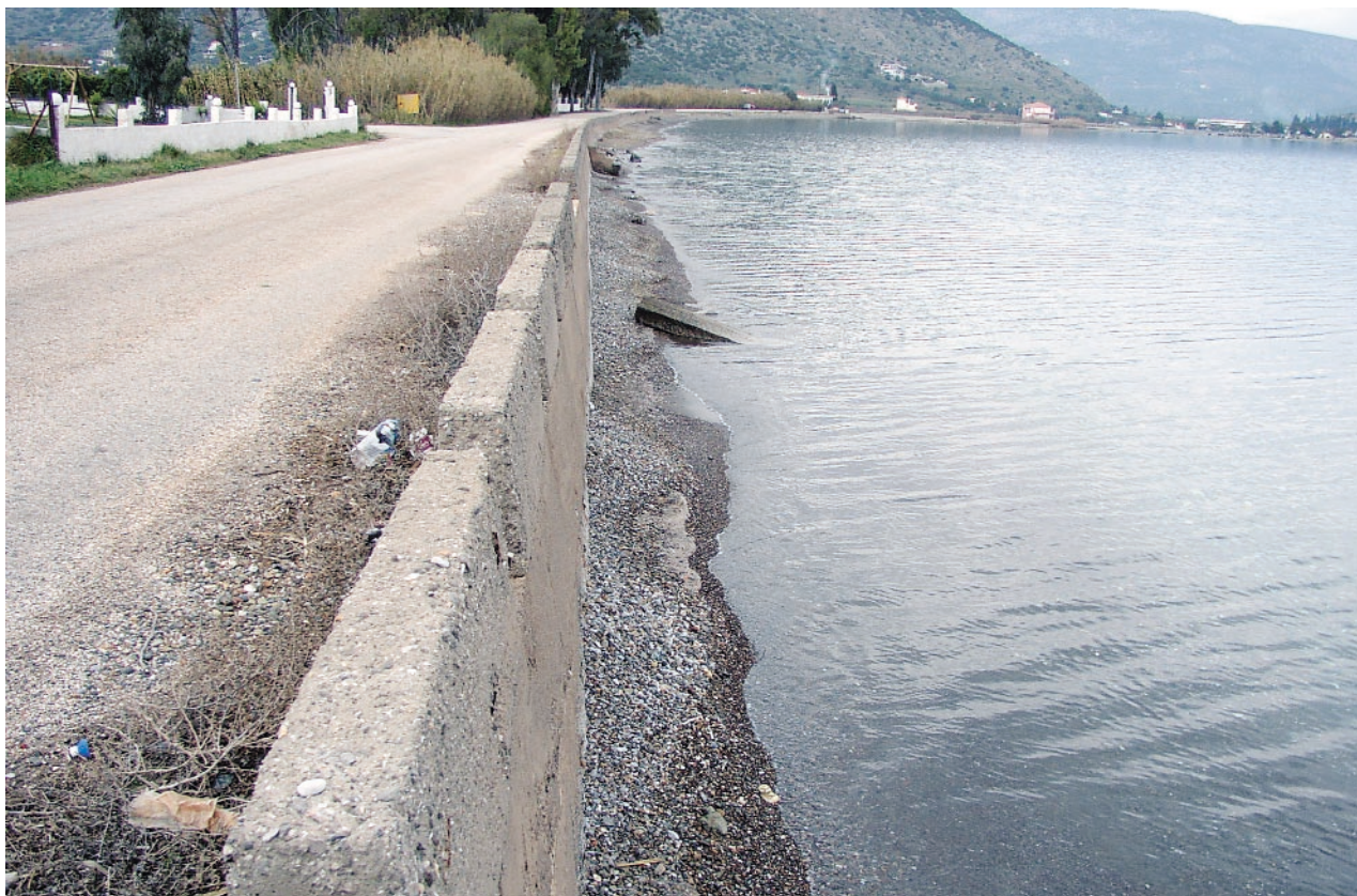
Φωτο 14.3 Τοιχίο (seawall) προστασίας του δρόμου από τη θάλασσα διάβρωση κατασκευασμένο από σκυρόδεμα σε ακτή της Αργολίδας.
